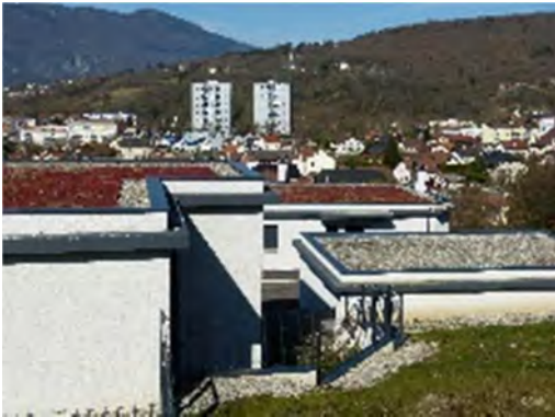
Evapotranspiration des pluies courantes par des toitures végétalisées
