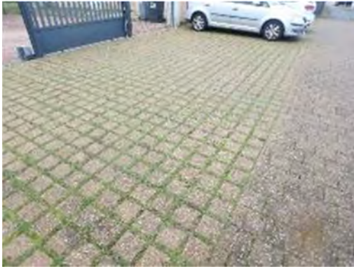
Infiltration des pluies courantes à travers un stationnement à joints poreux à Chalon-sur-Saône
